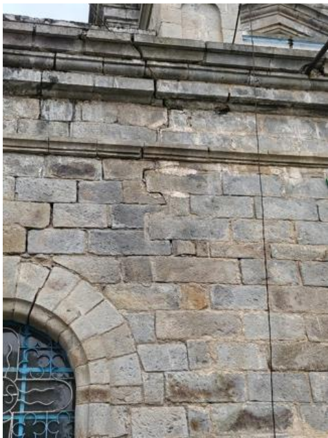
Figura 11: Fisuras y grietas.
