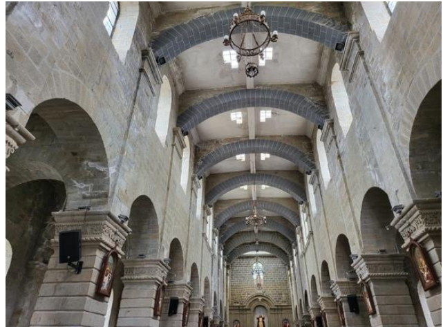
Figura 8: Deterioro por humedad.
