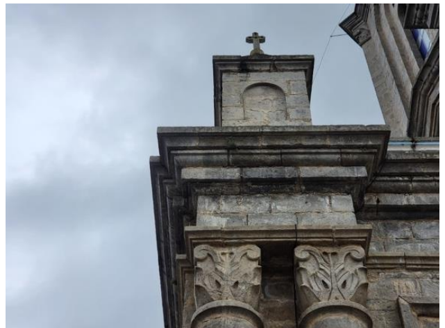
Figura 9: Consecuencias de la eflorescencia y criptoflorescencias
